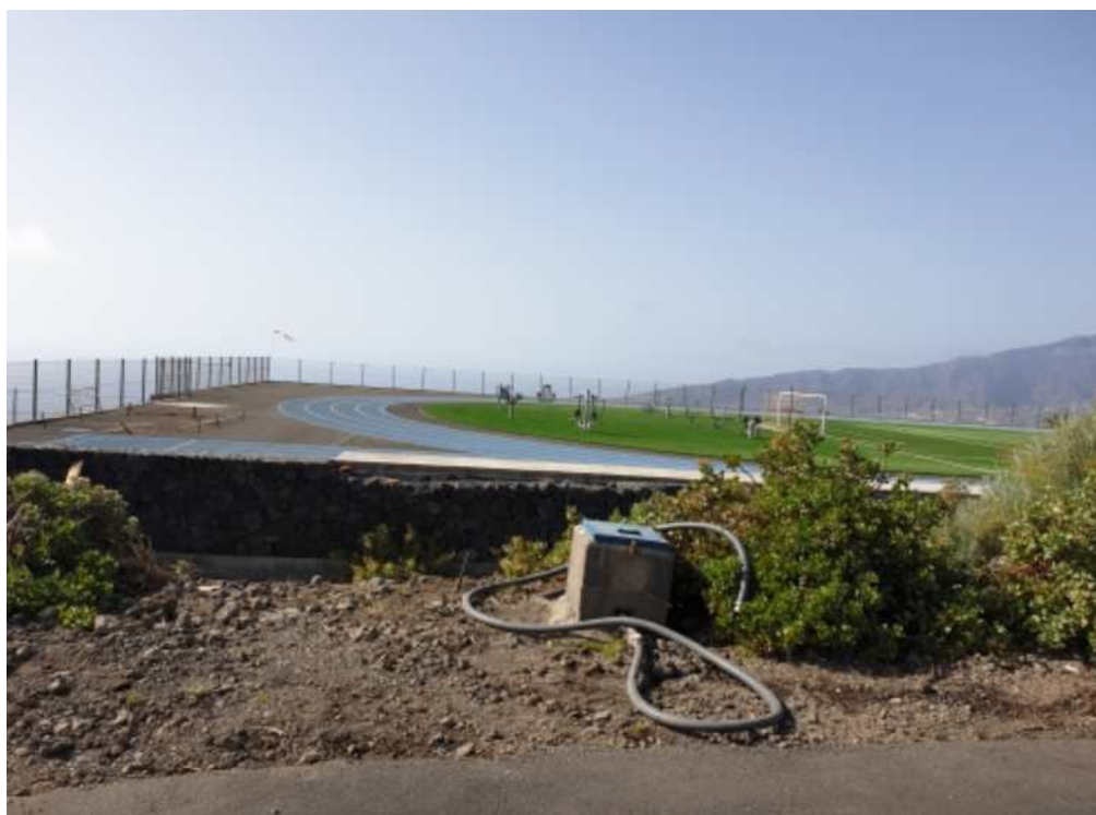
FOTOGRAFIA 6 Hidrante en Pabellón Federico Simón
